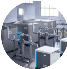
Tratamiento de Aire
