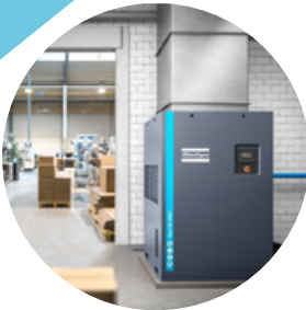
Compresores de Aire Comprimido
